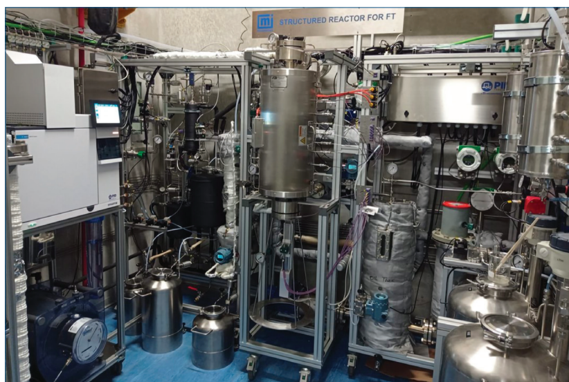
Fig. 2 - Impianto pilota per lo studio della sintesi di Fischer-Tropsch, installato al Dipartimento di Energia del Politecnico di Milano nell'ambito del progetto INTENT ( https://www.intent.polimi.it )
